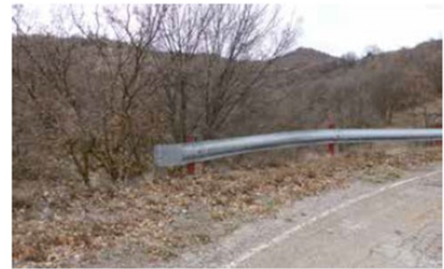
Barrera metálica de una sola onda. Carretera N-211-a; puerto de Bañón (Teruel).
